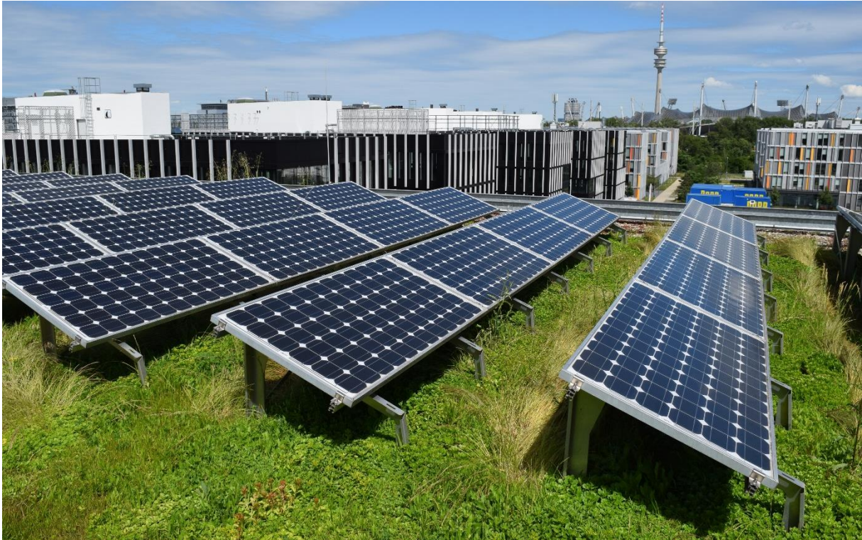
Solar-Gründach als Klimaschutz- und Klimaanpassungsmaßnahme (Bild: Bundesverband GebäudeGrün)
